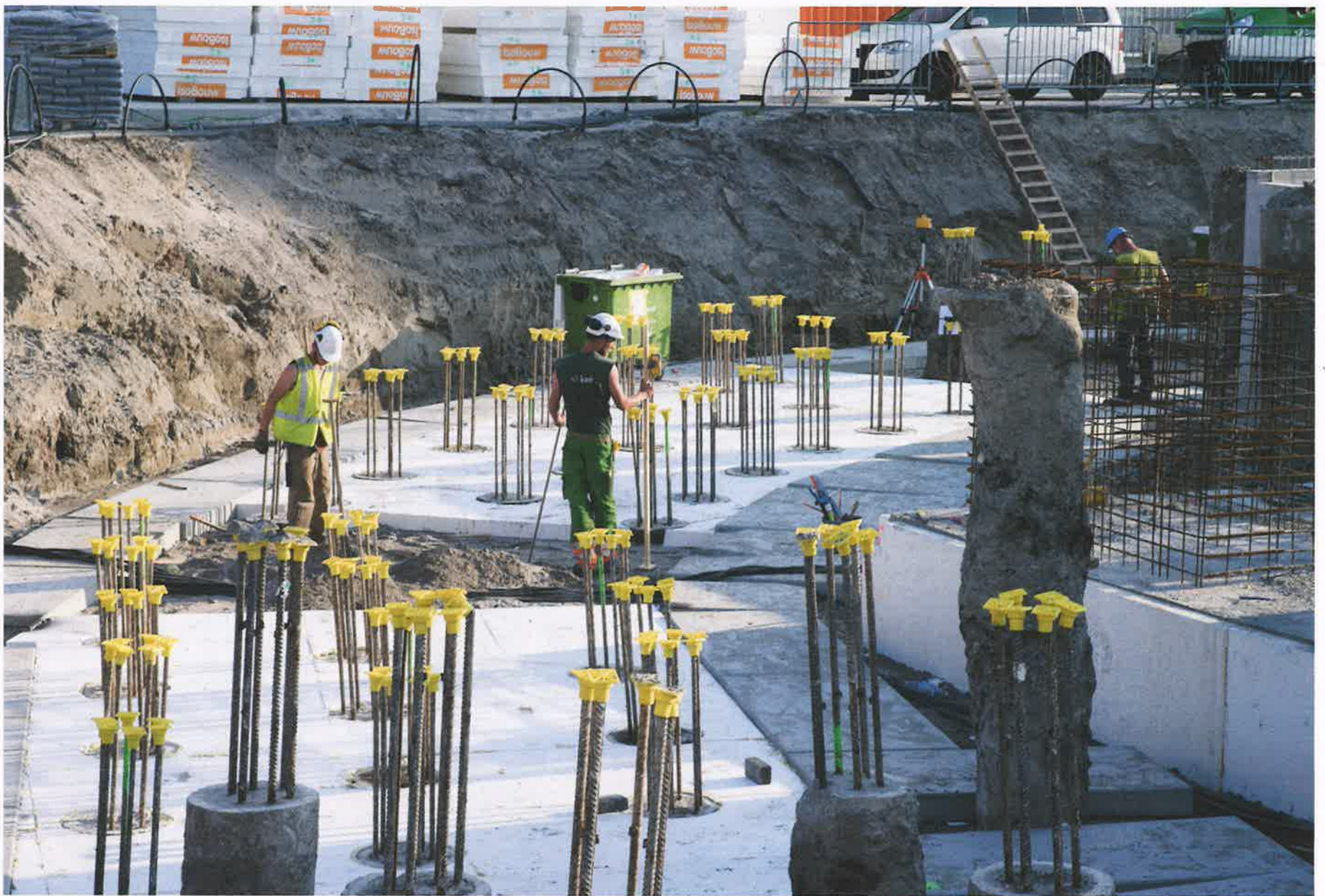
Van 40 meter op maaiveld groeit de betonconstructie uit tot een doorsnee van 60 meter bovenin. Foto: Rob Glastra
